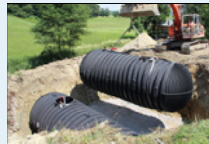
100 EW, Ettringen (Deutschland)
