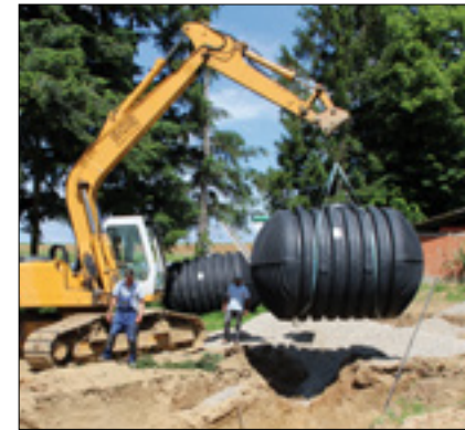
30 EW, Oberderdingen (Deutschland)
